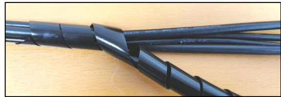
Abb. 20 – Kabelummantelung mit vielen Kabeln.
